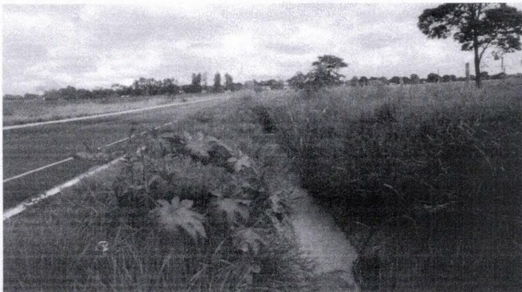
Figura 26 - Canaleta que transporta as águas da drenagem para descarga no pasto ao longo da estrada de acesso a Japorã
